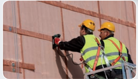
Fassadenabschirmung Trocken HEMP
