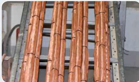
Stromkabel, Daten- und Versorgungsleitungen
